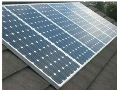
Solar PV Modules
